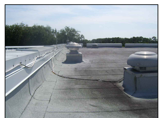
EXHAUST FAN EF-5 & O.A. INTAKE AHU-1 & 2
